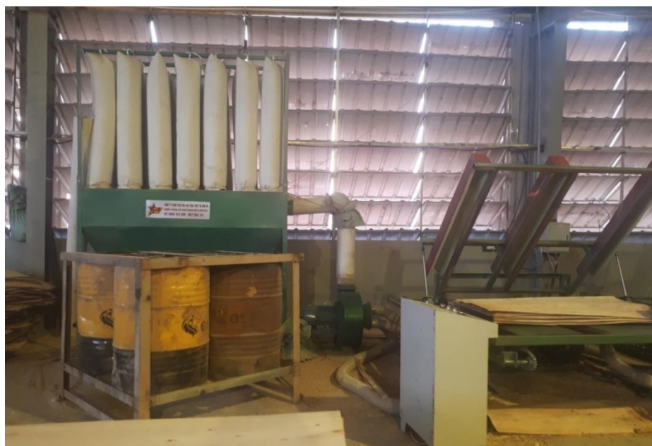
Hình 4. 5: Hình ảnh minh họa - Thiết bị xử lý bụi khâu cắt ván
