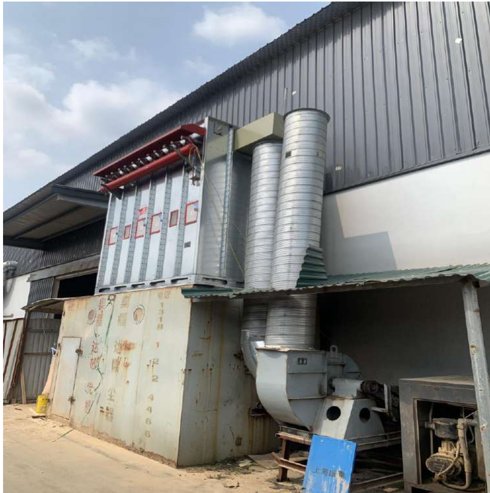
Hình 4.3. Hệ thống xử lý bụi gỗ phát sinh từ máy chà mặt
