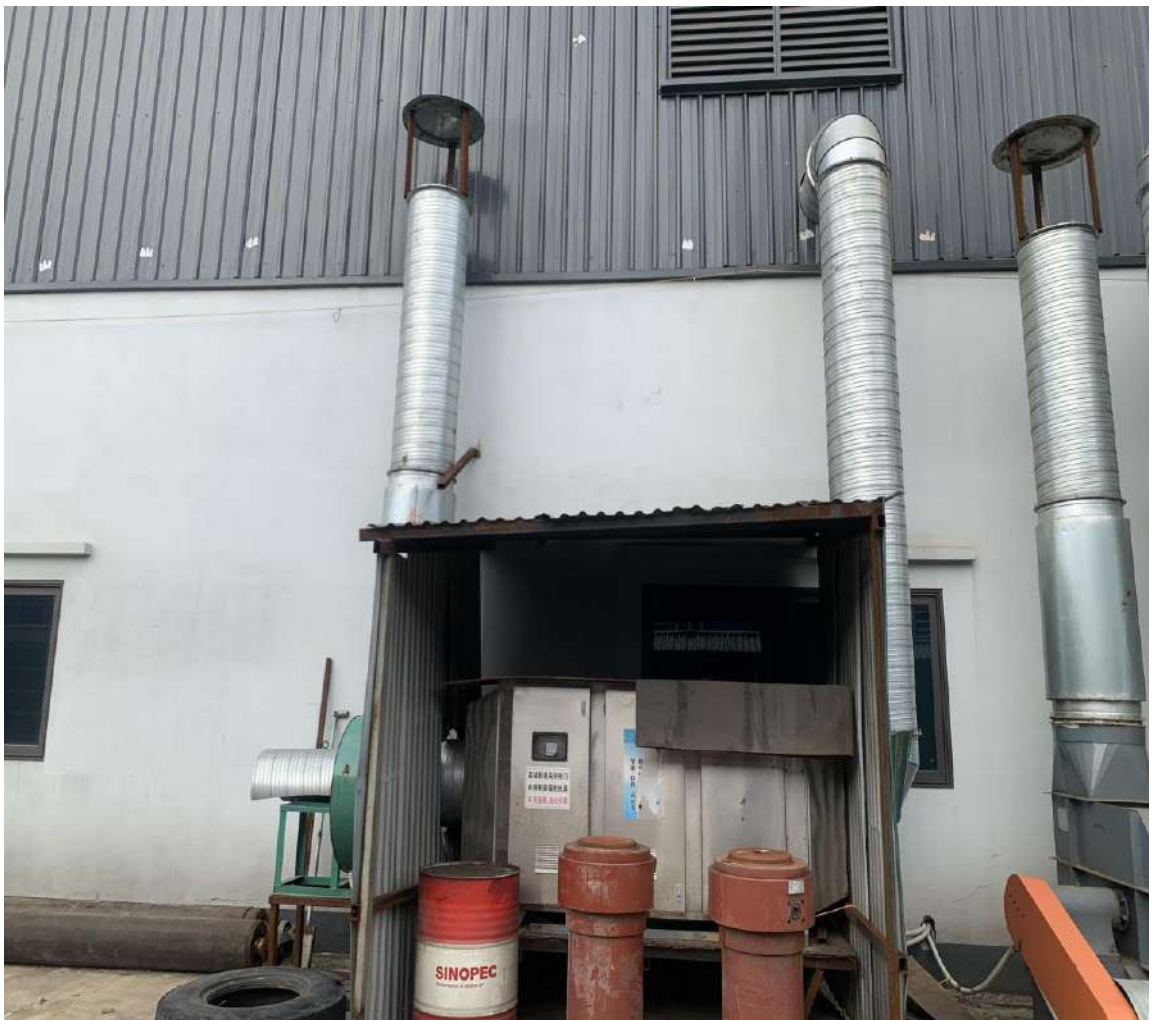
Hình 4.12. Hệ thống xử lý hơi sơn của dự án
